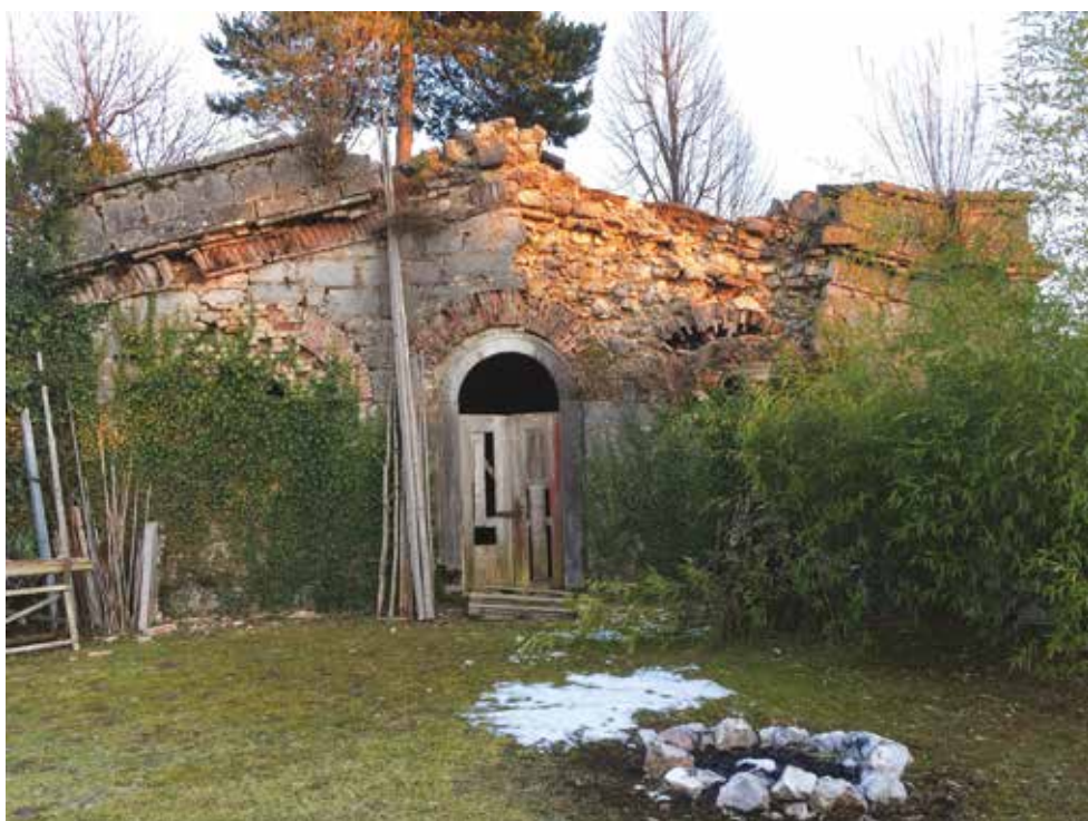
Danes vodohran propada. (© Mitja Fajdiga)
